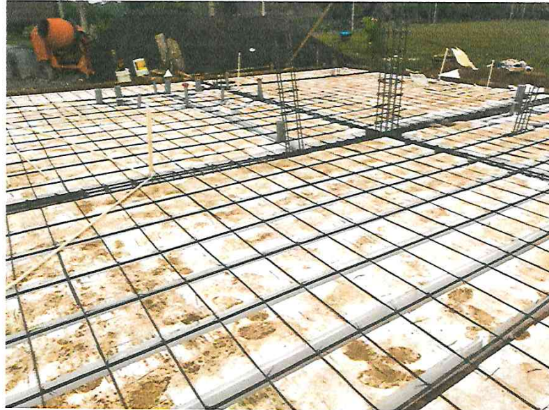
Fotografía N° 11.- vista panorámica de los trabajos de colocación del acero de temperatura e instalaciones eléctricas
